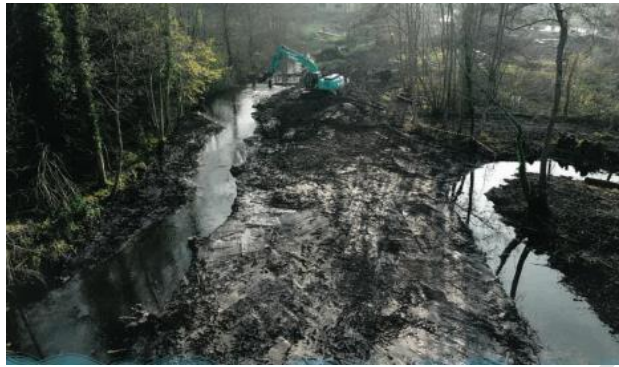
Figure 36 : photographie des zones humides de l'Œuf au Moulin de la Porte, en cours de travaux
